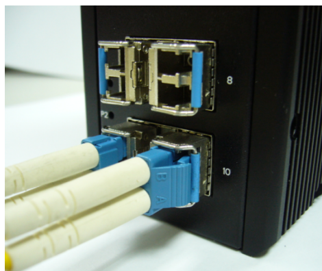
Вид подключения оптического кабеля к SFP модулю в IMS-410-2F
